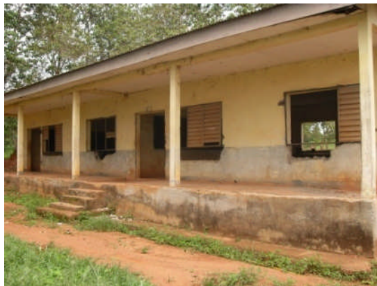
PHOTO 28 : Vue des salles de classe délabrées du Lycée de Kentzou
