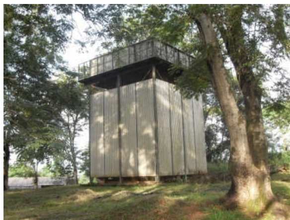
PHOTO 31 : Vue du château de l'adduction d'eau Scan Water de Kentzou en panne depuis plusieurs décennies.
